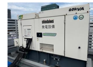
対象の非常用発電機
